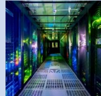
Green Datahub (data centres)
